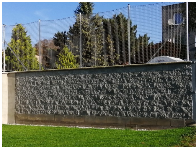
stěny jsou opatřeny ochrannými sítěmi
